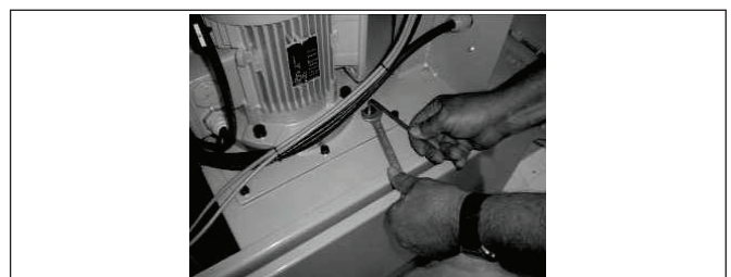
Figuur 64: Locatie van de ontluuchtingsschroef
