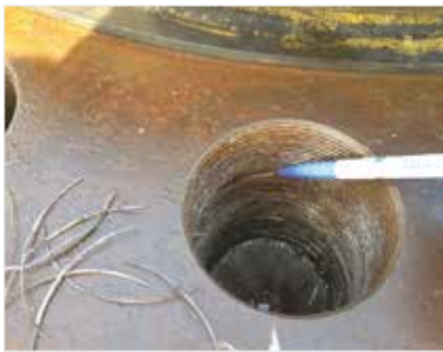
▲ Una rosca típica antes de la reparación.
