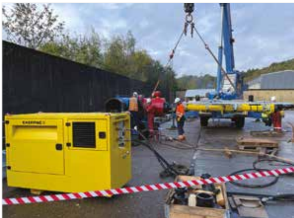
◀ Enerpac MHT2460-H Hot-Tapping-Maschine, angetrieben von einem Power Pack der PP44-Serie.
